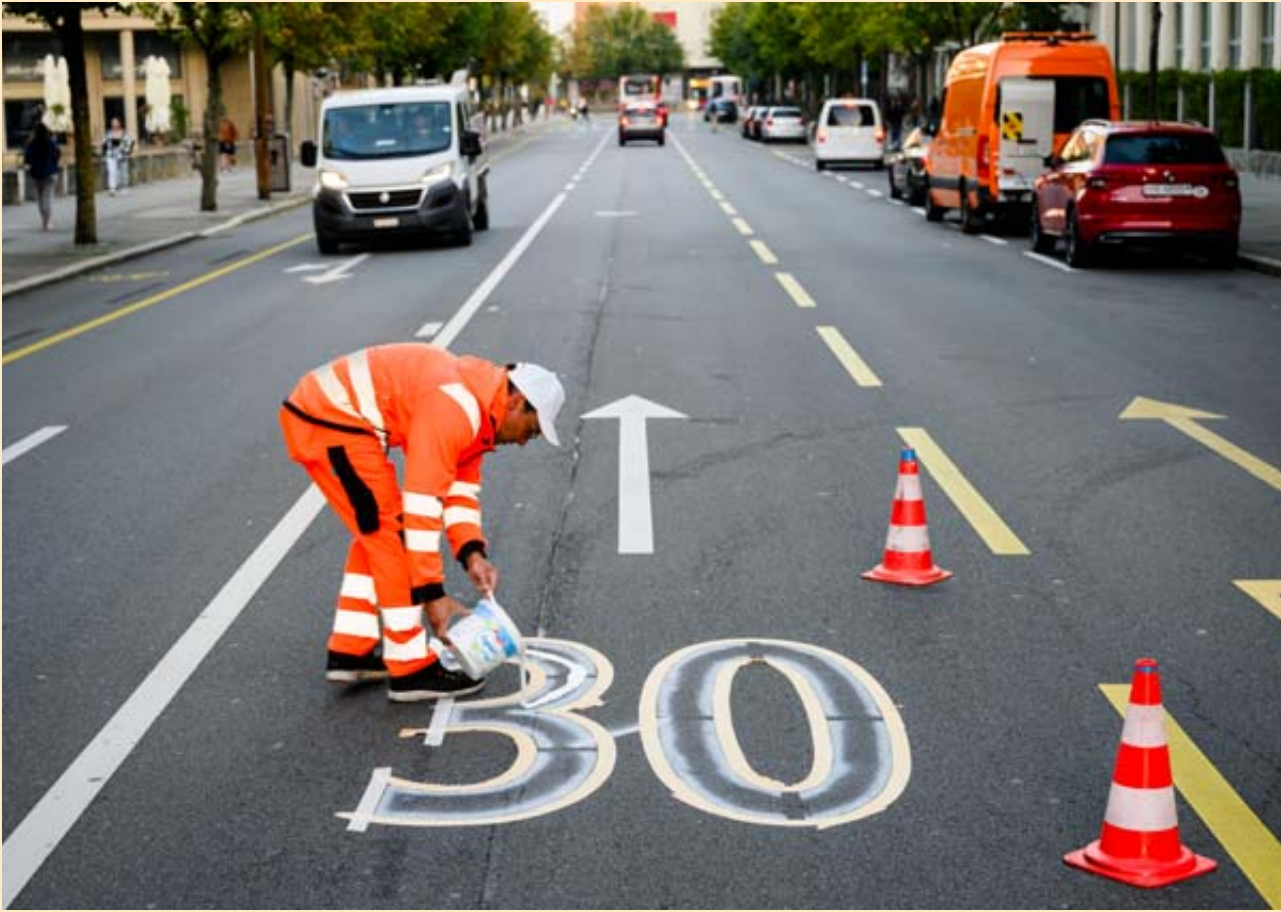
Un employé de la ville peignait hier l'inscription 30 km/h sur la route du boulevard de Pérolles à Fribourg. Pour lutter contre le bruit routier, la ville de Fribourg prend des mesures avec l'instauration, dès le 2 octobre, du 30 km/h en ville, sur une grande partie du réseau routier. KEYSTONE/JEAN-CHRISTOPHE BOTT
