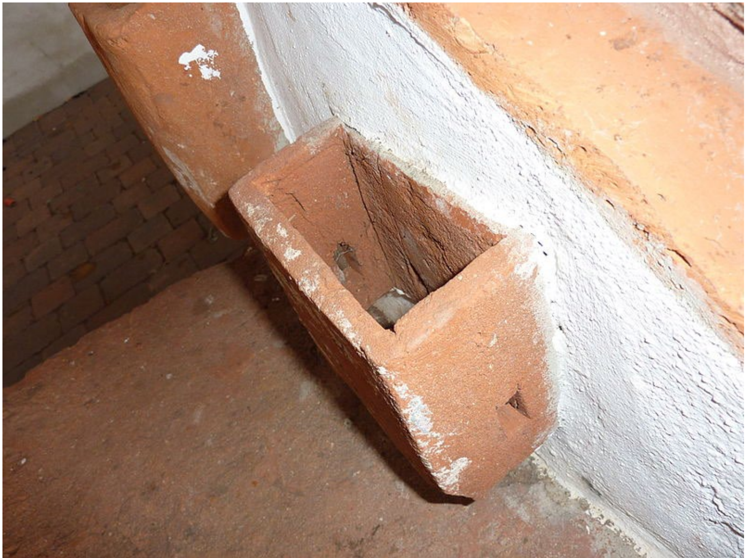
Chauffage des murs (tubuli) Kastel-Staad (Allemagne)
